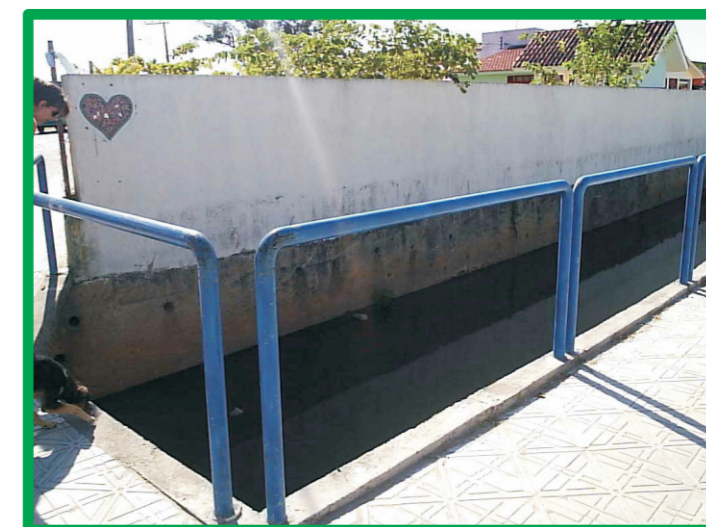
Foto 01 - córrego canalizado dentro do bairro: esgoto a céu aberto. (Cecília Adami Tanaka - 05/04/2008)
